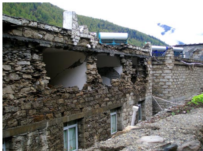
2階部分の損傷が多い。
